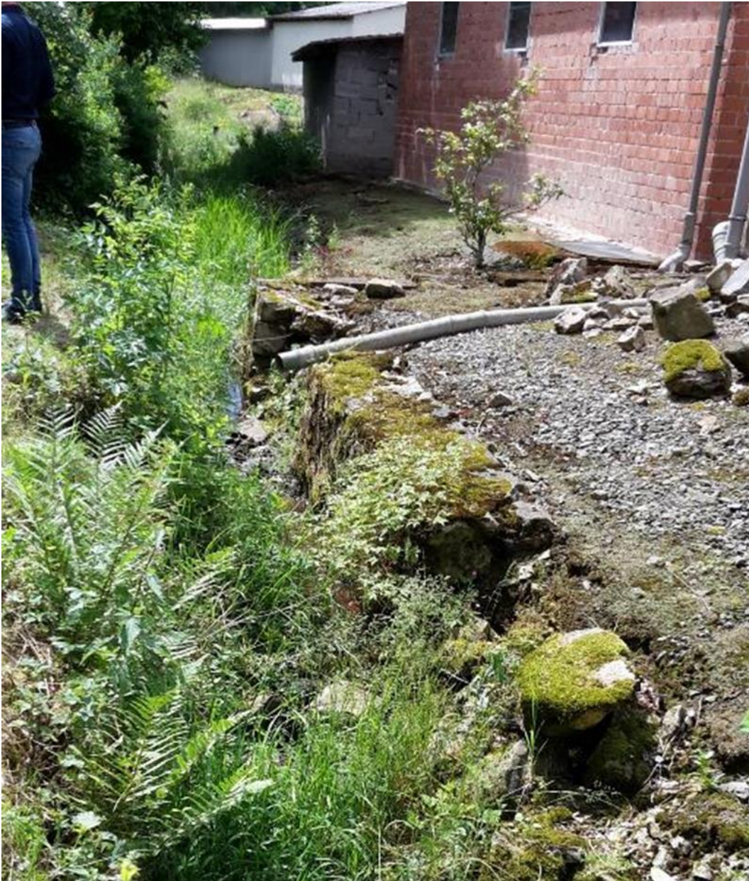
Abb. 5: Pfaffenbach am Ortseingang von Ottrau, Uferbefestigung rechts teils erodiert.
