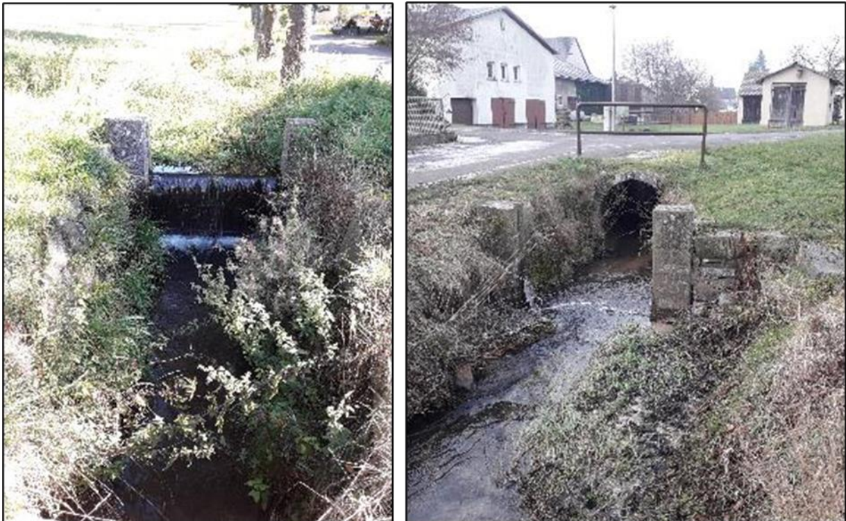
Abb. 8: Stauwehr an der Grenff in Görzhain (Uferweg). Links mit eingesetzten Staubrettern (Aufnahme vom 30.09.2022); hier ist eine Wanderung stromaufwärts für Wasserorganismen unmöglich. Rechts im Winter (10.02.2023) ohne Staubretter, so kein Wanderhindernis.
